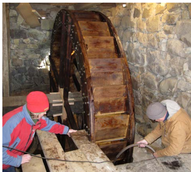
Installation och inprovning av ena kvarnhjulet. Magnus Börjesson, Vasstak Kullabygden (t.v.) och Pelle Nilsson, Domstens Kulturbyggnad (t.h.) som tillsammans tillverkat vattenhjul, drev och kronhjul. Kvarnaxlarna har rekonstruerats av bröderna Ravanis på Nyhamns Såg & Båtbyggeri i Brücke.
